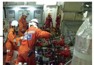
せいびちゆう ボイラ整備中
