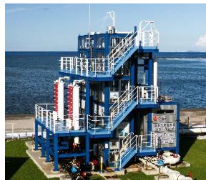
OTEC実証設備(久米島)
